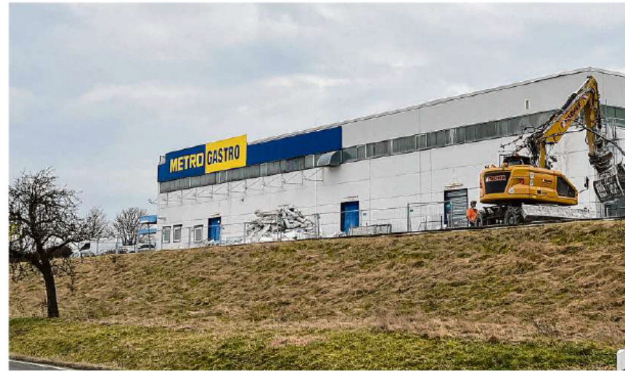
Von außen betrachtet geht es bei den Bauarbeiten am leerstehenden Einkaufszentrum voran. Doch liegt der Investor mit seinem Umbau auch im Zeitplan? Foto: Nico Nissen
